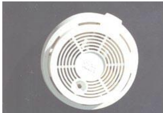
사진 5-55. 화재경보기를 집안에 설치해서 화재와 화상을 예방한다. 그리고 불이 나면 화재로 생 긴 열과 독성 가스를 피해 안전한 곳으로 도피하는 방법을 알아둔다.
